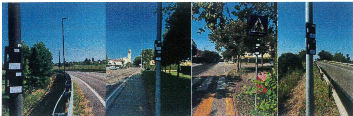
Figura 16. Installazione dispositivi video contatraffico.
